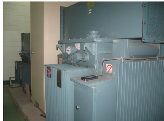
圖 3. PDA 巡視器讀取變壓器設備電子標籤
