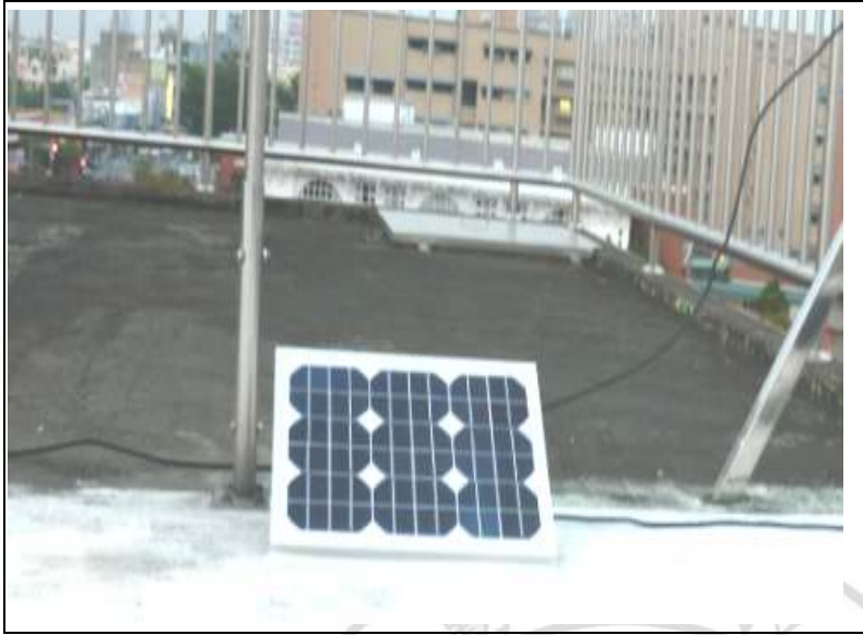
圖 4-9 太陽能發電設施之照片
