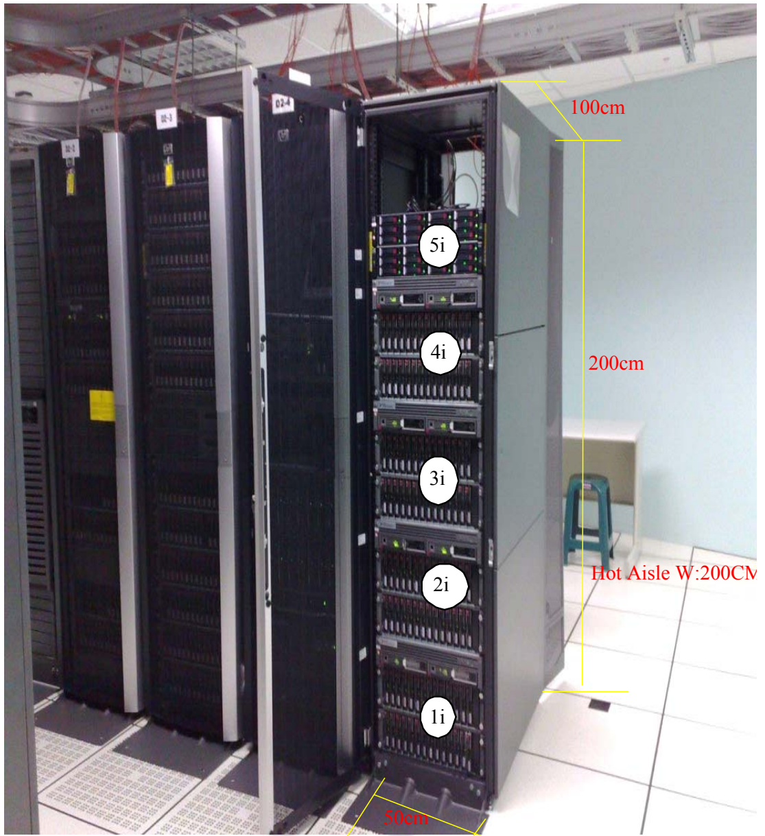
4.24、機櫃吸風側風速、溫濕度量測點
